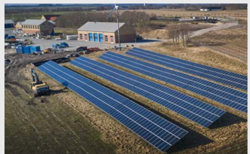
Fornæs Renseanlæg med solceller.
