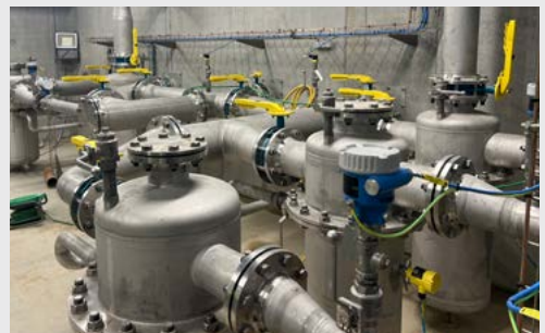
Maskinrum på Fornæs Renseanlæg.
